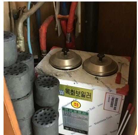
図6 チョクパンの（練炭）ボイラー室
